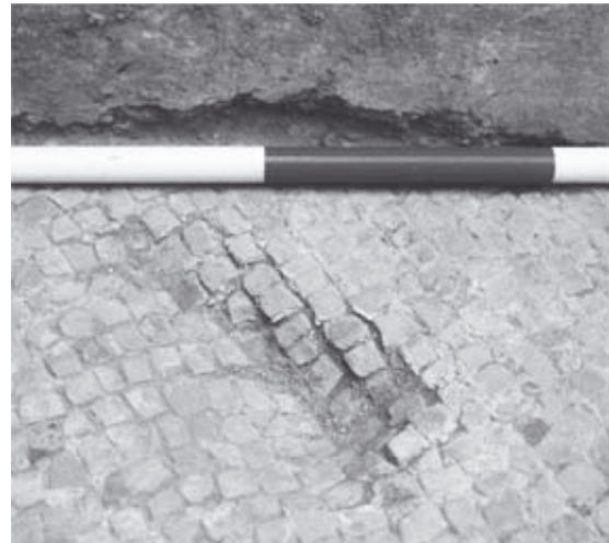
Abb. 80: Raum 38a, Schadspuren im Mosaikboden, Detailaufnahme
