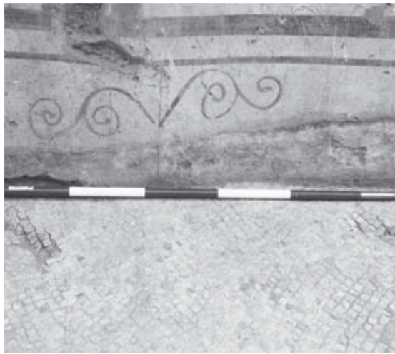
Abb. 79: Raum 38a, Schadspuren im Mosaikboden
