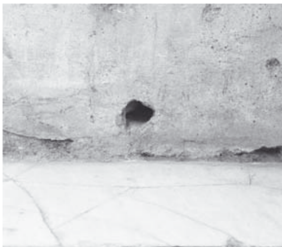
Abb. 77: Peristylhof 38b, Kanalloch in der Ostwand
