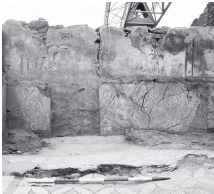
Abb. 90: Raum 38d, aufgewölbter Mosaikboden mit Erdbebenriss
