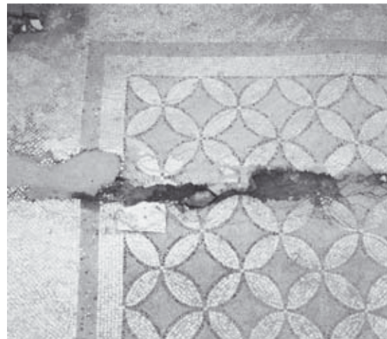
Abb. 92: Raum 38d, Mosaikboden mit Erdbebenriss
